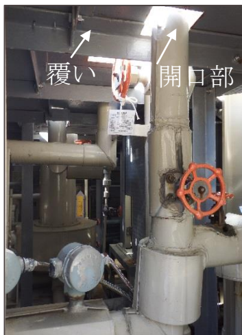
図1 覆い下部の状況
