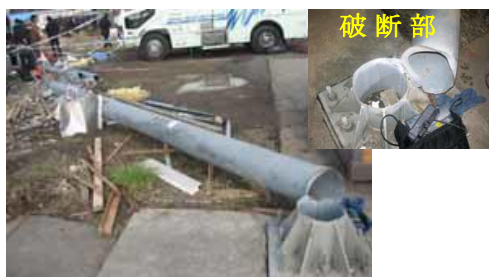
倒壊した道路標識支柱
