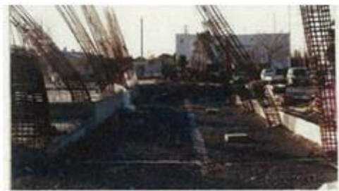
曲がった鉄筋(工事現場)
