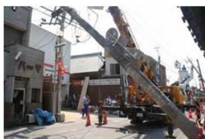
倒れた電柱(復旧作業時)
