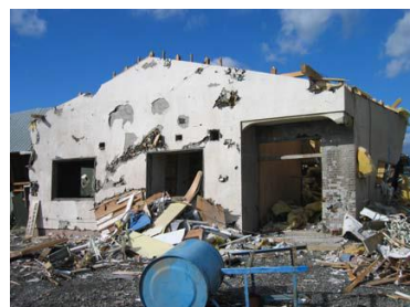
飛来物による被害を受けた建物
