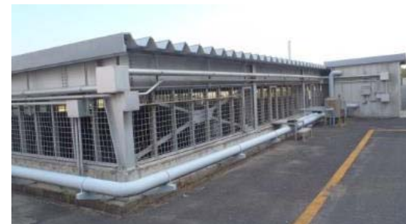
排水貯留ポンド外観
