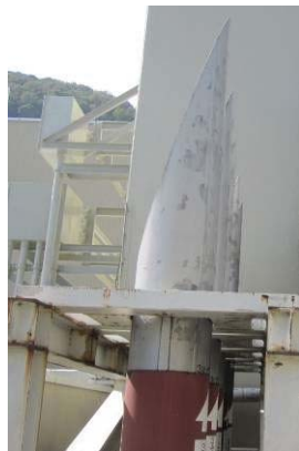
図 3 主蒸気安全弁（排気管）の設置状況（3号機）
