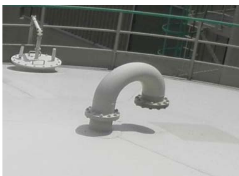
図 2 復水タンクベント管
