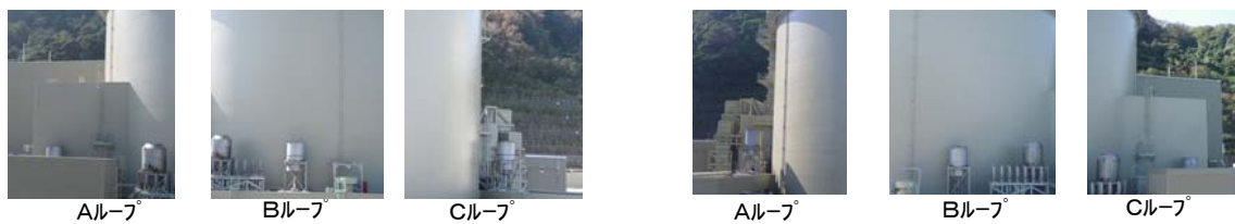
図3 主蒸気逃がし弁消音器の設置状況（左3号機、右4号機（各3系統））
