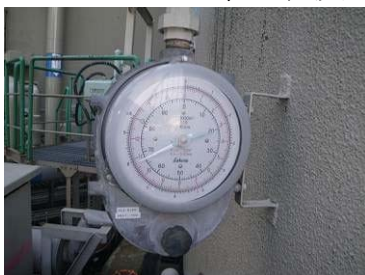
図 1 復水タンク水位計
