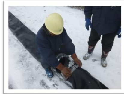
建屋外ホース接続 (300A)
