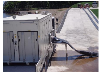
可搬型建屋外ホース接続 (300A)
