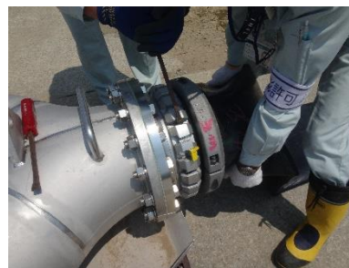
二口分岐接続 (300A×300A×2口)
