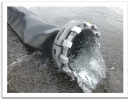
建屋外ホース接続箇所 （300A）
