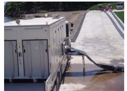
可搬型建屋外ホース接続 （300A）
