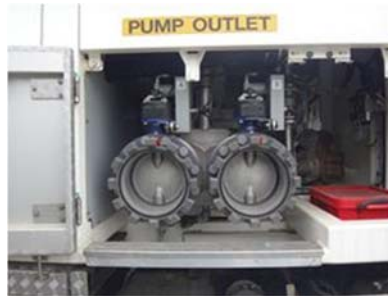
大型移送ポンプ車吐出部 可搬型建屋外ホース接続箇所 （300A）
