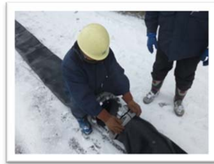
建屋外ホース接続 （300A）
