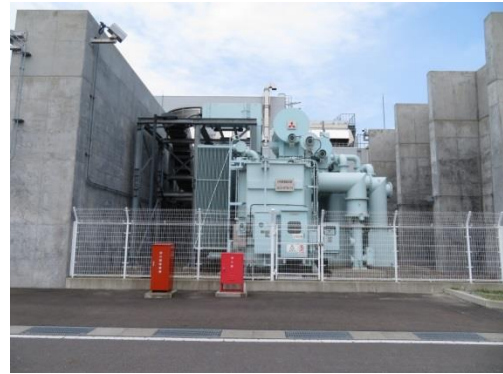
4号受電変圧器
