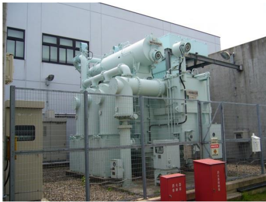
1号受電変圧器
