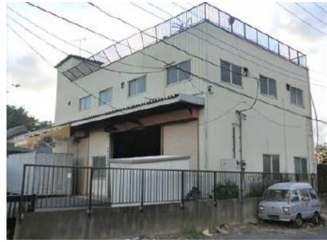
屋上フェンスの変形
