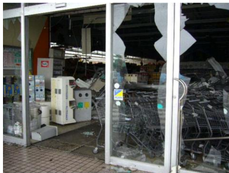
エントランスの窓ガラスの破損
