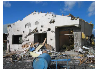
飛来物による被害を受けた建物
