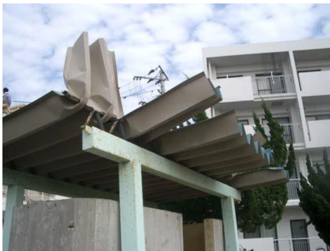
屋外トイレ屋根の損傷
