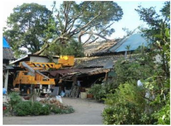
樹木の倒壊による小屋組の被害
