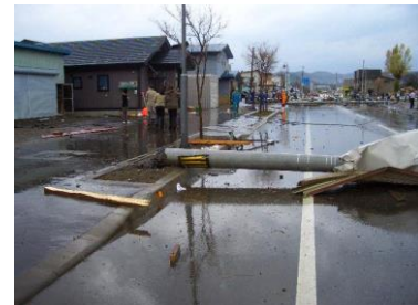
道路側へ倒壊した電柱
