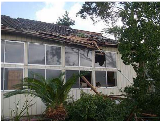
倉庫の窓ガラスと屋根の被害状況
