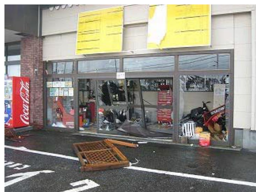
エントランスのガラス損壊
