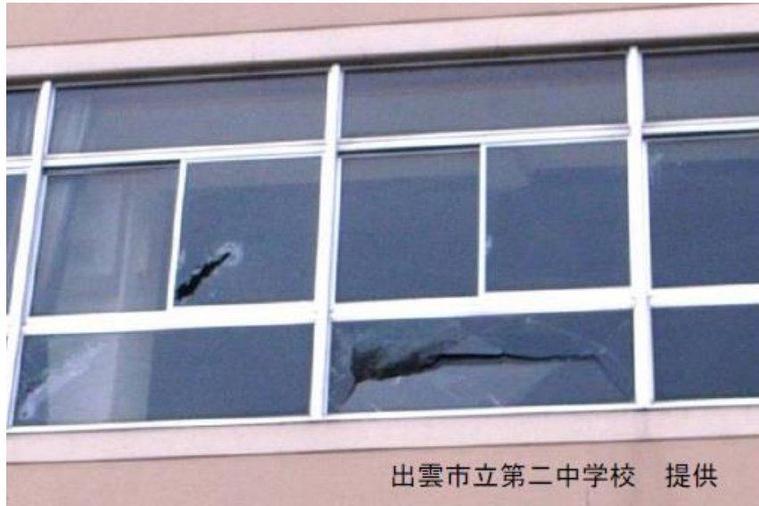
体育館窓ガラスの損傷
