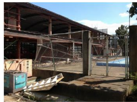
フェンスの変形（工事中の建築物）
