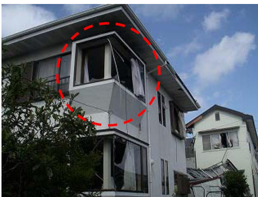
出窓部の窓ガラスの損壊
