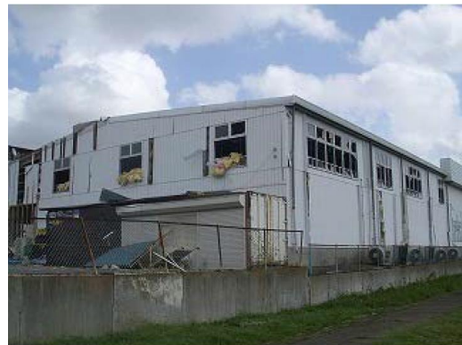
窓ガラスの損壊
