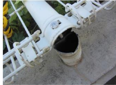
フェンス支柱部の破損
