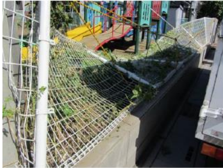
フェンスの変形
