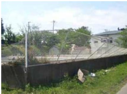
フェンスの変形
