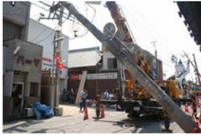
倒れた電柱(復旧作業時)
