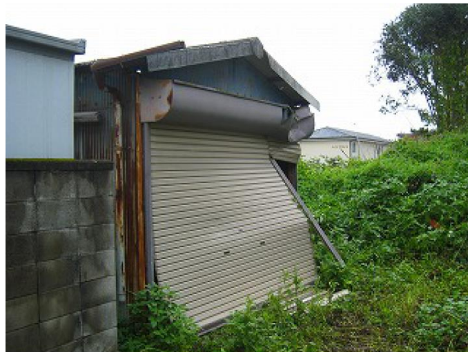
シャッターの外れ
