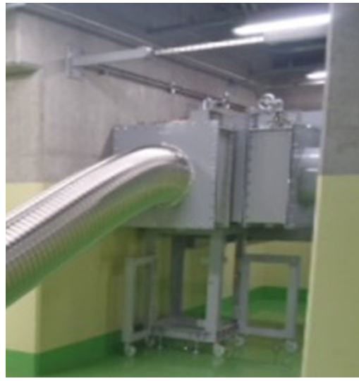
(可搬型設備と常設設備はフランジにより接続している)
