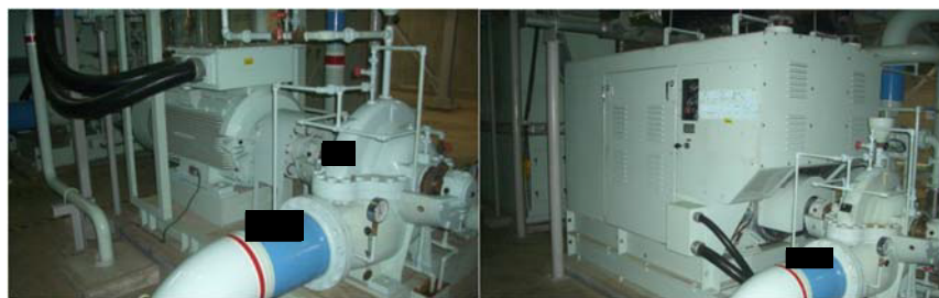
電動機駆動消火ポンプ
