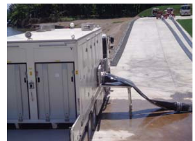
可搬型建屋外ホース接続 (300A)
