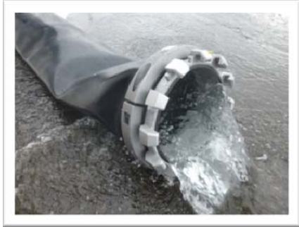
建屋外ホース接続箇所 (300A)
