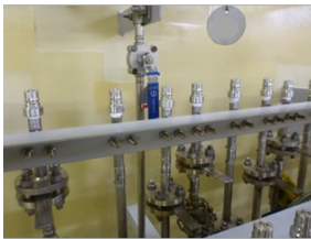
接続口 20A配管
