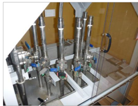
接続口 25A配管
