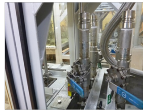
接続口 40A配管
