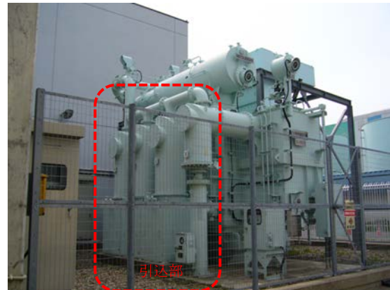
受電変圧器（露出部無し）
