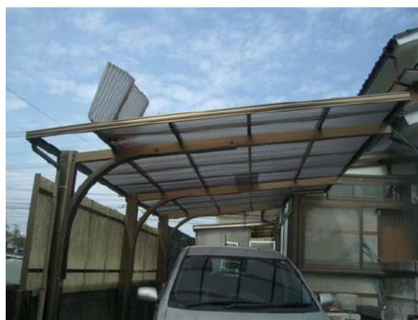
カーポート屋根の損傷
