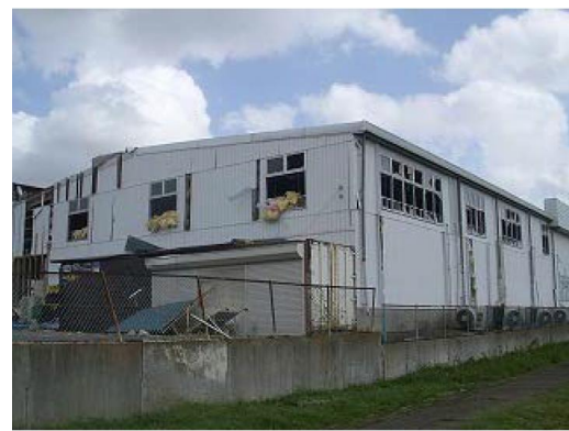
窓ガラスの損壊
