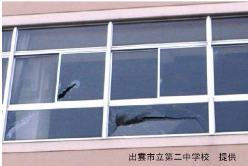
体育館窓ガラスの損傷
