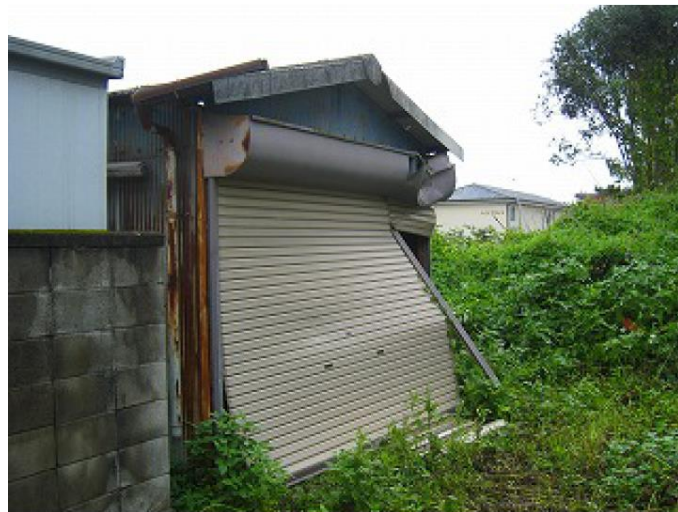
シャッターの外れ
