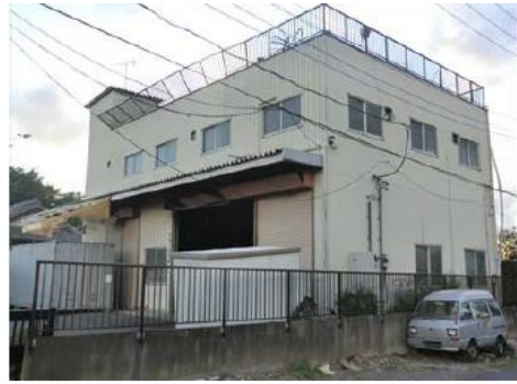
屋上フェンスの変形
