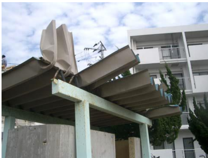
屋外トイレ屋根の損傷
