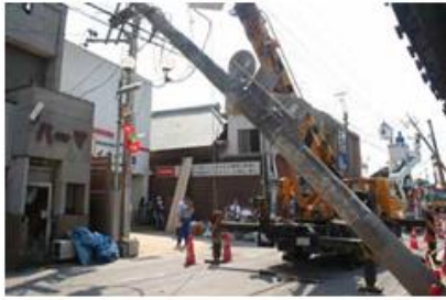
倒れた電柱(復旧作業時)
