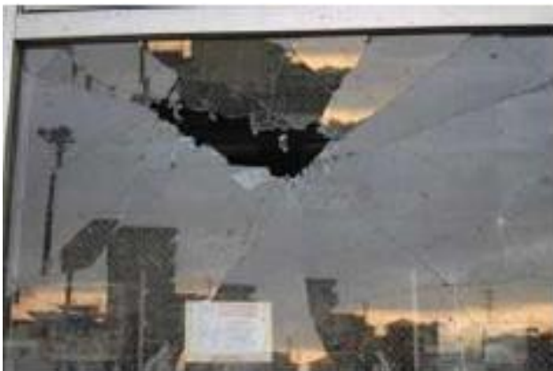
ガラスの被害状況（飛来物衝突痕）
