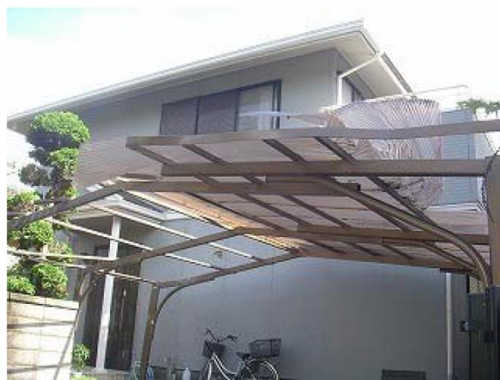
カーポートの被害
