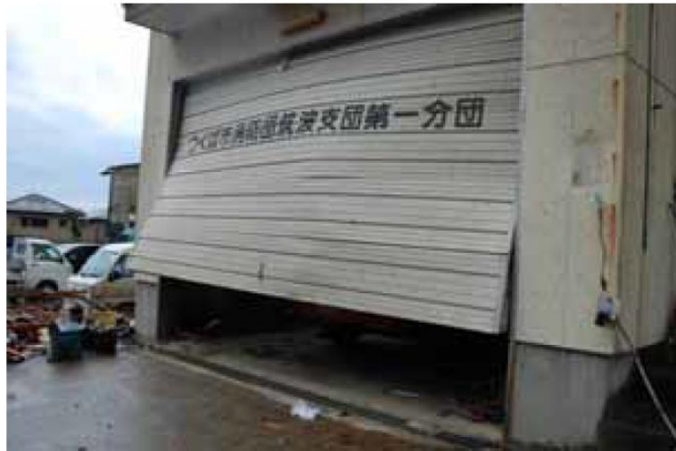
消防団施設のシャッターの変形
