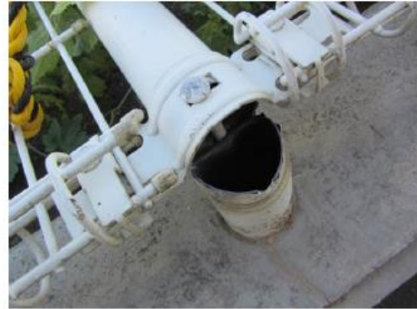
フェンス支柱部の破損
