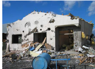
飛来物による被害を受けた建物
