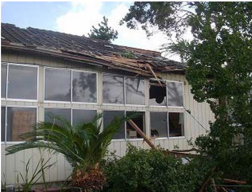
倉庫の窓ガラスと屋根の被害状況
