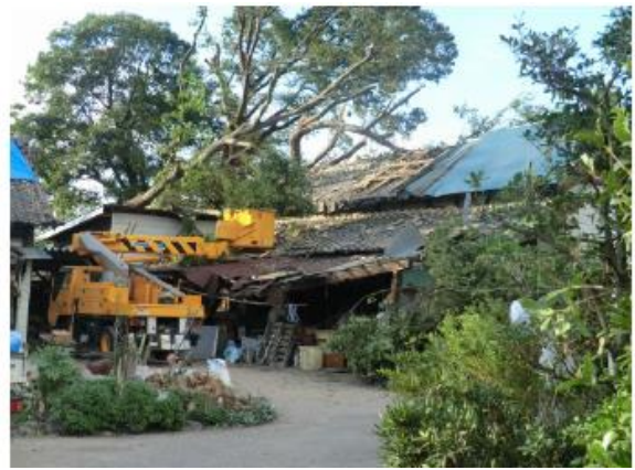
樹木の倒壊による小屋組の被害
