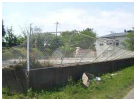
フェンスの変形
