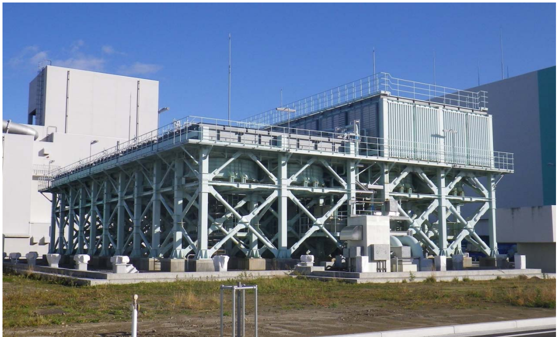
18. 冷却水設備：安全冷却水B冷却塔 [ ██████████ ]
