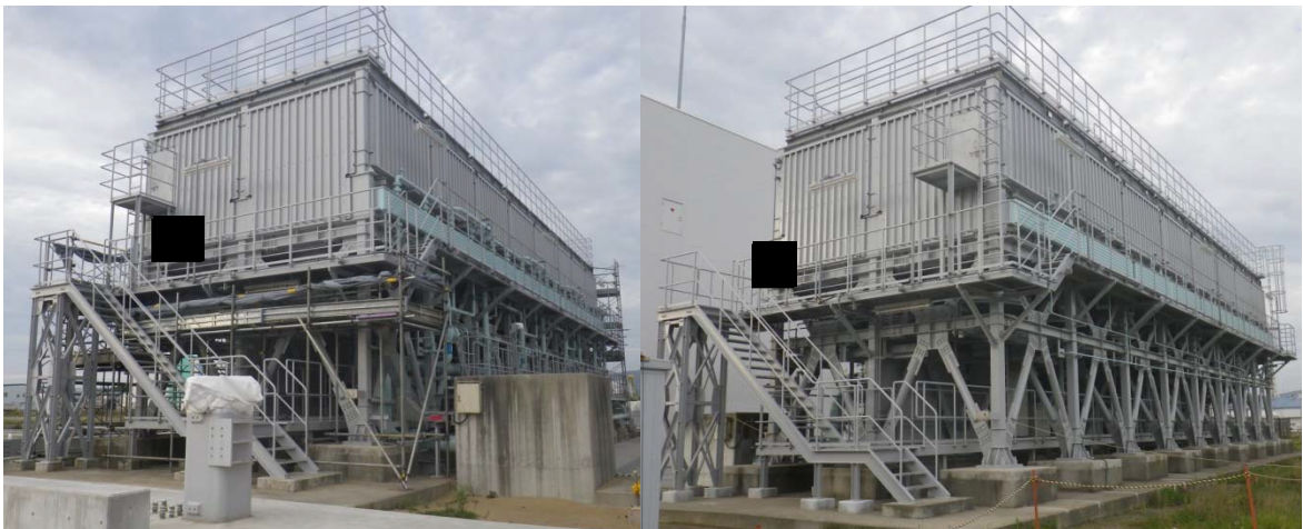
16. G10 非常用電源建屋 冷却水設備： 冷却塔 A / B [ XXXXXXXXXX ]
