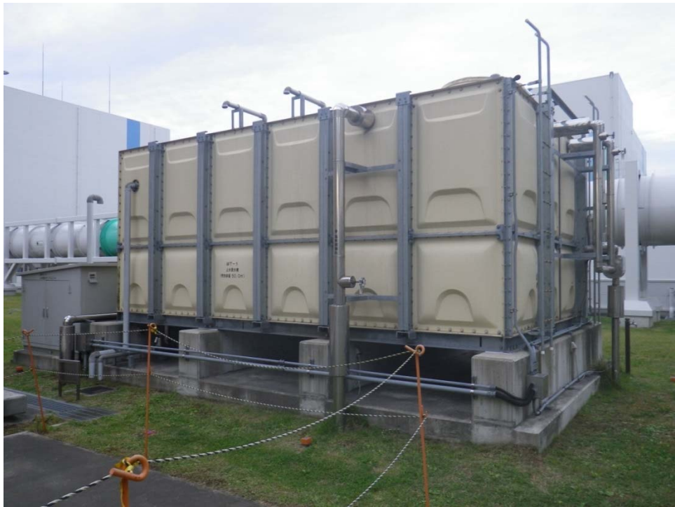
15. H 2 W 再処理事務所 西棟：受水槽
