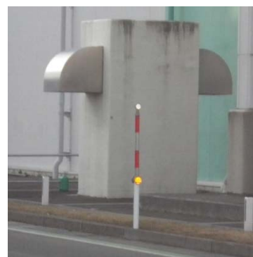
洞道の排気口
