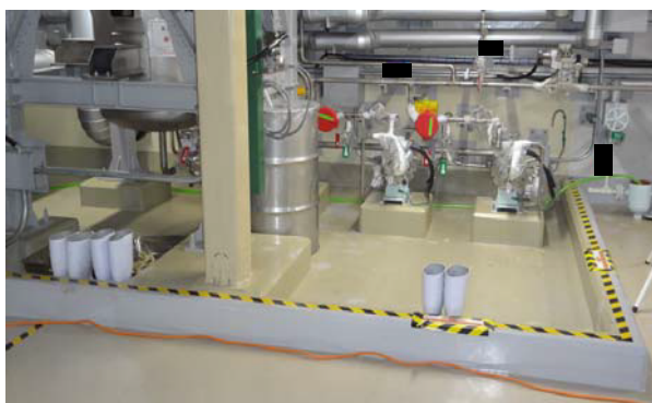
第1図 法令に基づき設置している堰
