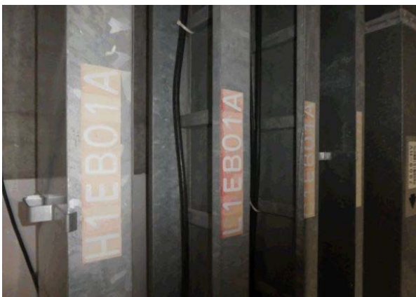
使用済み燃料受入れ・貯蔵施設用冷却 設備基礎(B) 安全系ケーブルトレイ (A) (B系は遠方にある)
