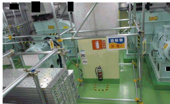
前処理建屋換気設備 セル排風機
