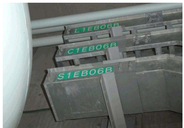
使用済み燃料受入れ・貯蔵施設用冷却 設備基礎(B) 安全系ケーブルトレイ (B) (A系は遠方にある)
