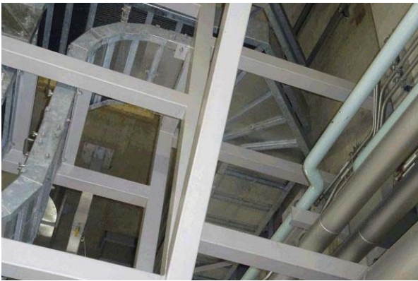
ウラン・プルトニウム混合脱硝建屋 安全系ケーブルトレイ (B) (カメラ死角に A 系あり)
