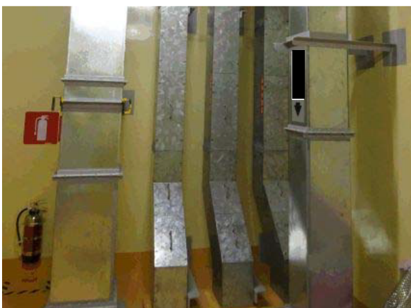
ウラン・プルトニウム混合酸化物貯蔵建屋 安全系ケーブルトレイ (A) (カメラ死角に B 系あり)
