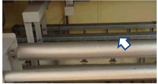
精製建屋 安全系ケーブルトレイ (A) (カメラ死角に B 系あり)
