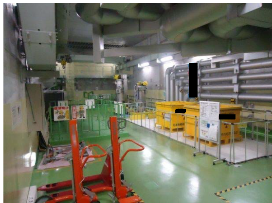
高レベル廃液ガラス固化建屋 機器搬送第3室
