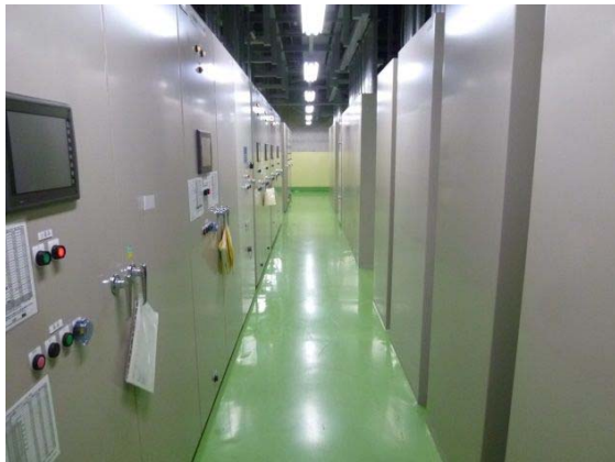
高レベル廃液ガラス固化建屋 現場盤第1室
