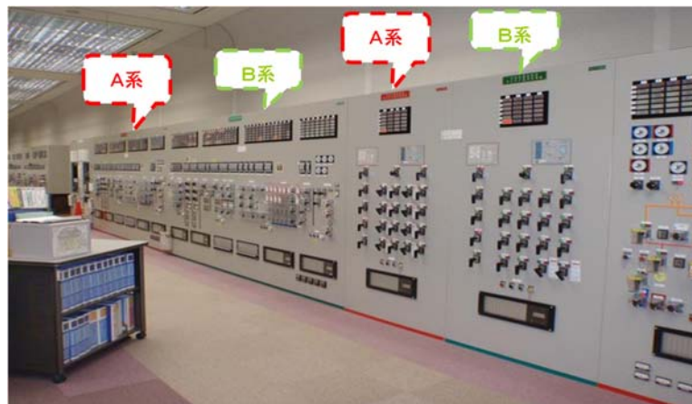
第10図 中央制御室 安全監視制御盤
