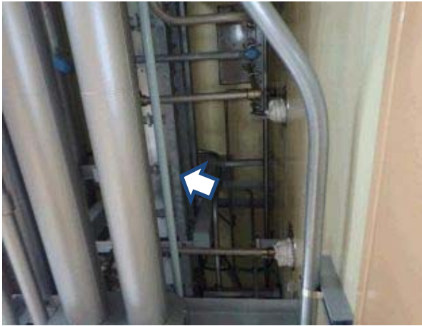
精製建屋 安全系ケーブルトレイ (B) (カメラ死角に A 系あり)
