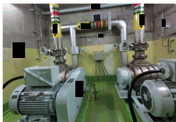
分離建屋 塔槽類廃ガス処理設備 排風機
