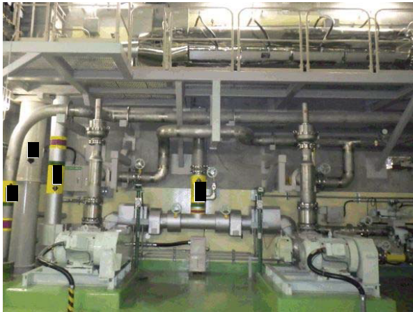
高レベル廃液ガラス固化建屋 塔槽類廃ガス処理設備 排風機
