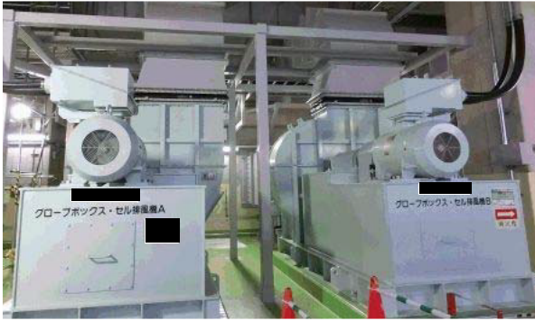
分離建屋換気設備 グローブボックス・セル排風機
