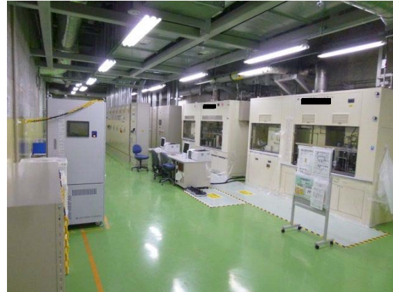
高レベル廃液ガラス固化建屋 現場盤第2室
