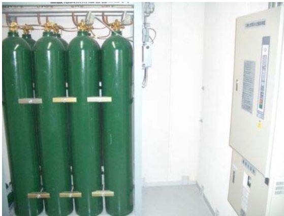
CO 2 ボンベ設置状況
