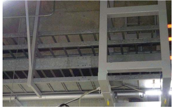
ウラン・プルトニウム混合脱硝建屋 安全系ケーブルトレイ (A) (カメラ死角に B 系あり)
