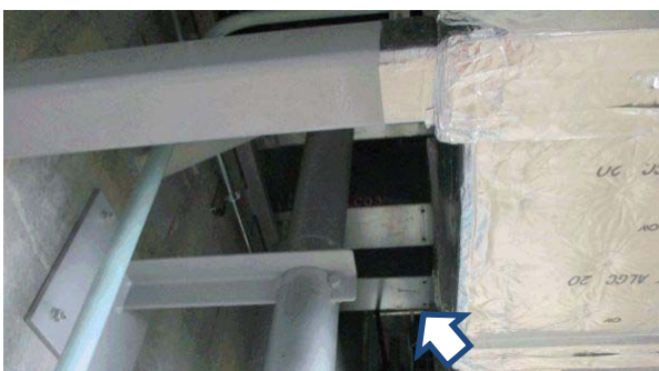
前処理建屋 安全系ケーブルトレイ (A) (カメラ死角に B 系あり)
