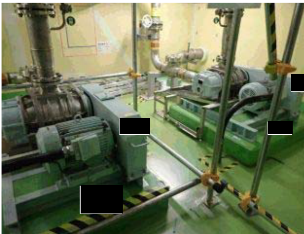
精製建屋 パルセータ廃ガス処理設備 排風機
