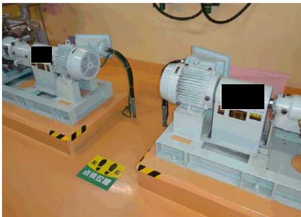
ウラン・プルトニウム混合脱硝建屋 安全冷却水系 冷水移送ポンプ
