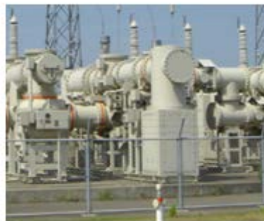
第 3-3-2 図 受電開閉設備のフェンス（小動物対策）
