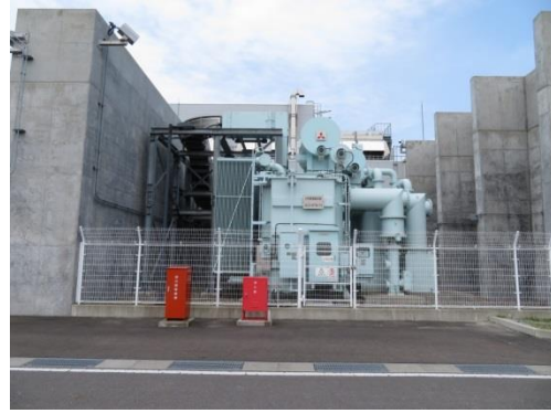
4号受電変圧器
