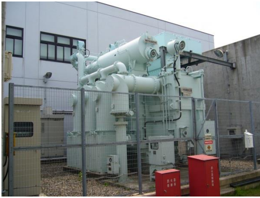
1号受電変圧器
