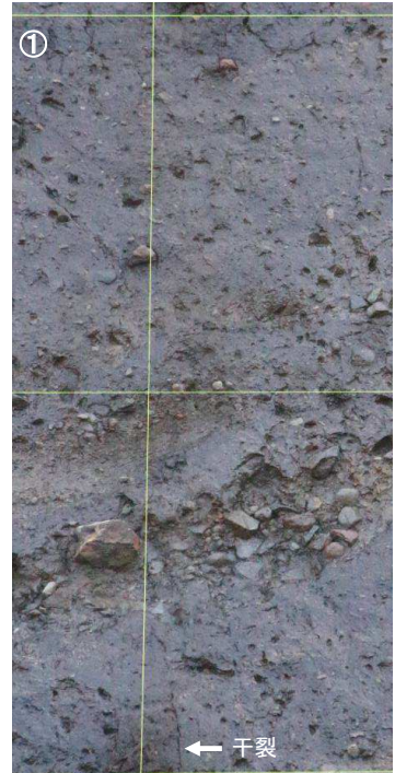
開口する高角度の干裂
