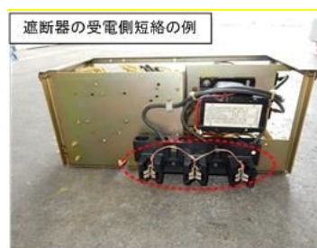
図 4.5.3 遮断器の短絡箇所 (C/C試験時)
