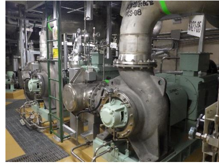
1次冷却材主ポンプ
