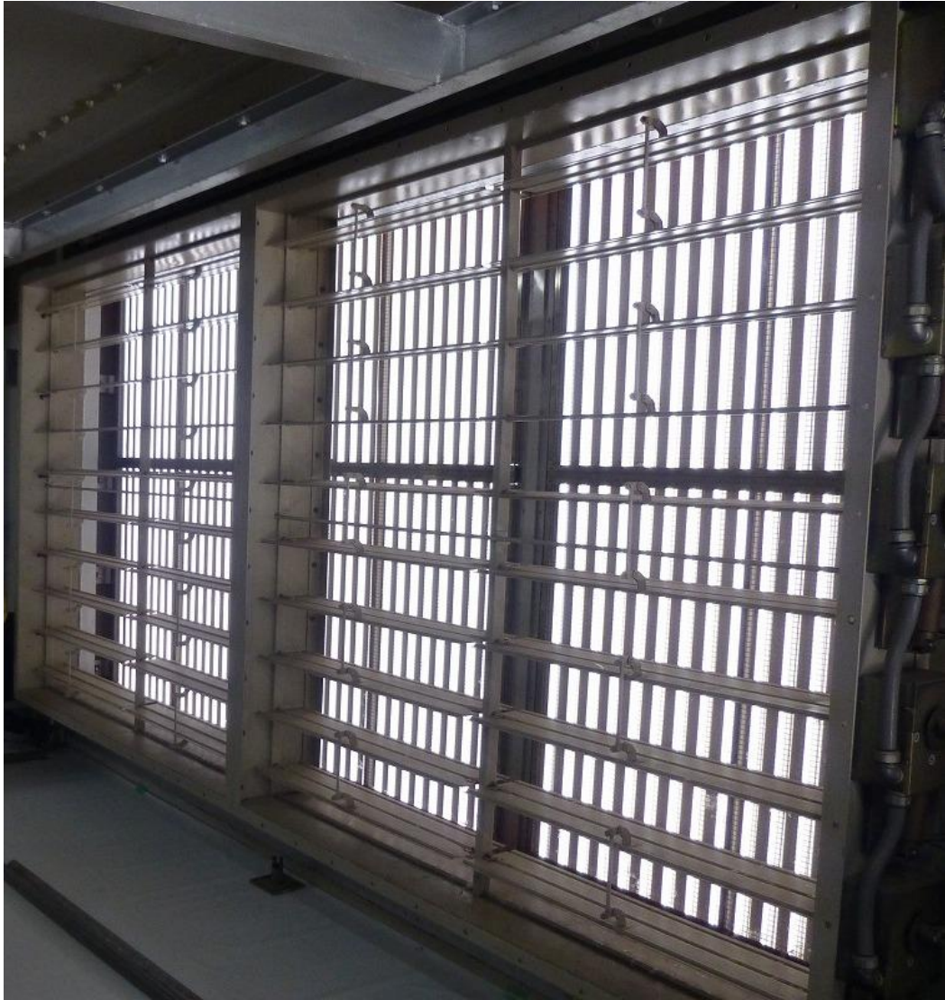
図 3 屋外開放ダンパの外観
