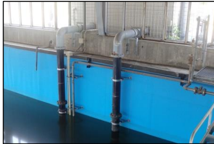
貯留槽吸込み配管 (A及びC)
