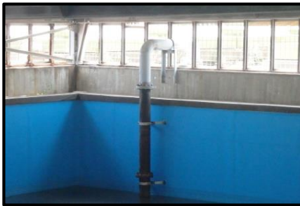
貯留槽吐出配管 (B)
