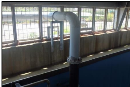
貯留槽吐出配管 (D)
