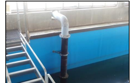
希釈槽吸込み配管 (E)
