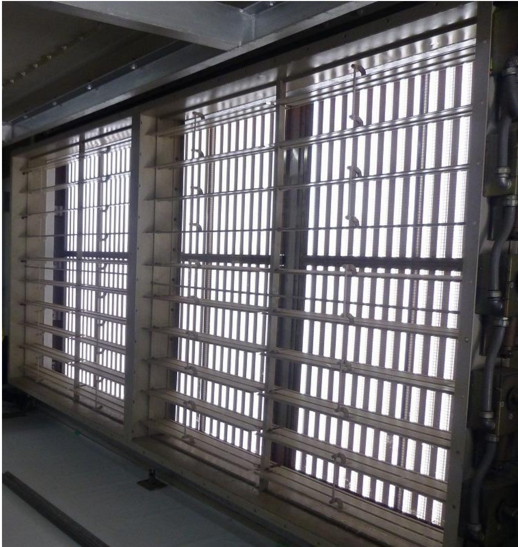
図 3 屋外開放ダンパの外観
