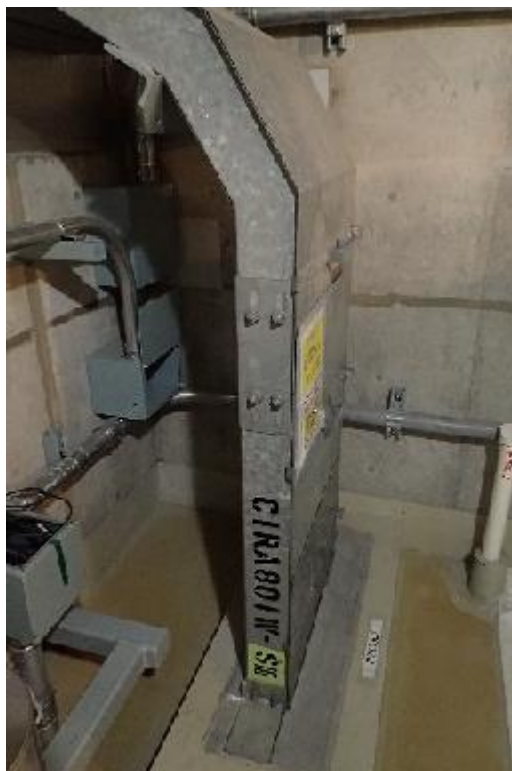
第2図 ケーブルトレイ床貫通部外観
