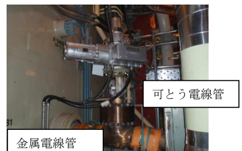
機器へのケーブル取合い (電動弁との取合い)
