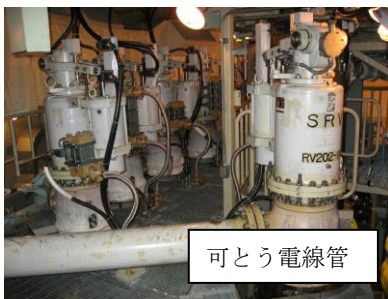
機器へのケーブル取合い (主蒸気逃がし安全弁との取合い)
