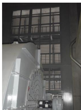
A-ディーゼル室送風機 及び火山灰対策（フレーム）
