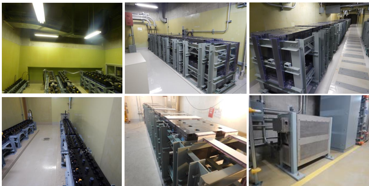
第1-39図 蓄電池の設置状況 (1 / 7)
