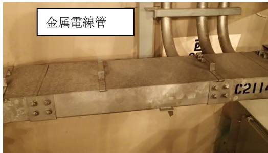
金属製の密閉ダクト (蓋付ケーブルトレイ)
