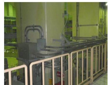
電線管及び端子箱
