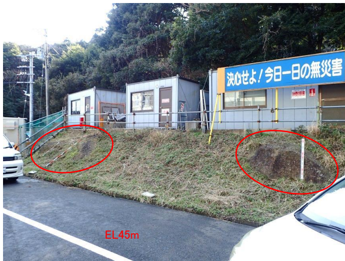
P3 EL45mの盛土部より山側斜面は堅硬な岩盤が露岩している。
