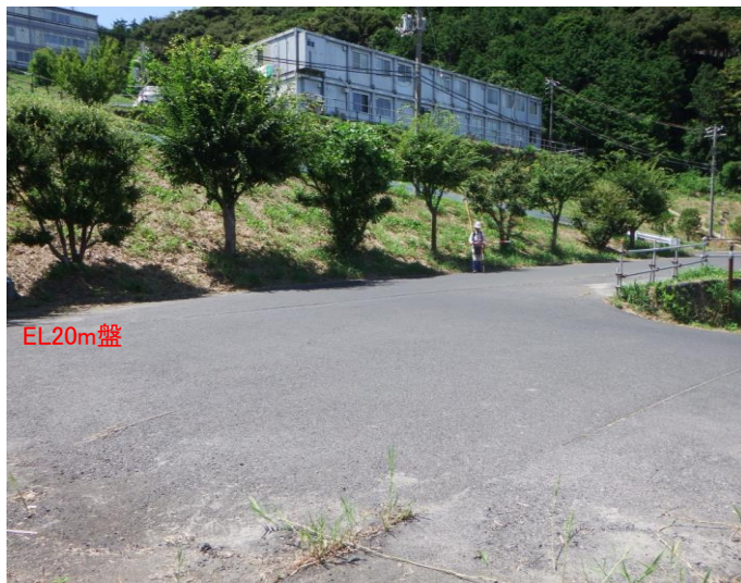
P5 谷底部の盛土下部では、道路及び法面に目立った変状は認められない。盛土斜面は安定した状態であると考えられる。
