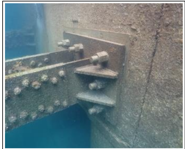
参考写真：海中に設置後1年半程度経過した貝付着状況 (高浜1,2号炉非常用海水路閉塞防止措置の状況)
