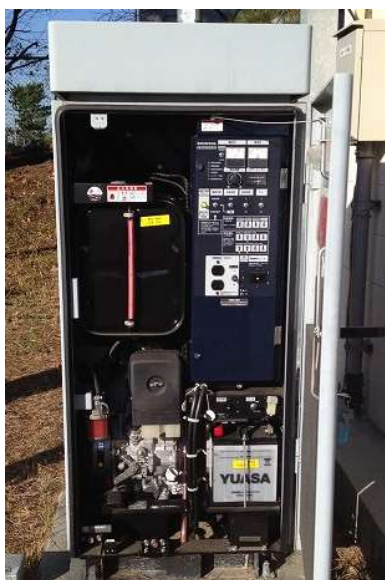
自動起動式設置型発電機の写真
