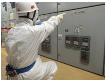
遮断器手動投入
