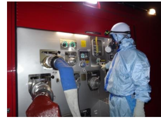
ポンプ起動操作（夜間）
