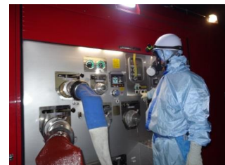
ポンプ起動操作（夜間）
