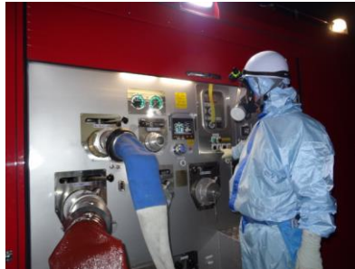
ポンプ起動操作（夜間）
