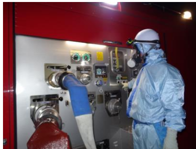
ポンプ起動操作（夜間）
