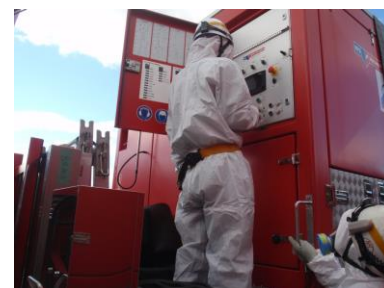
ポンプ起動操作
