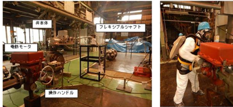
ベント操作（遠隔手動弁操作機構）
