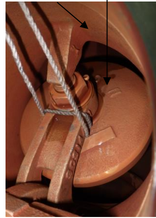
② 逆止弁内部 (弁全開状態)
