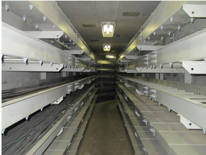
図3② ケーブルダクト室内
