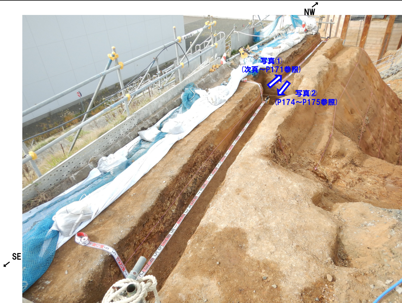
開削調査箇所(南側) 追加人力掘削調査 写真(天端南側から北側を望む)
