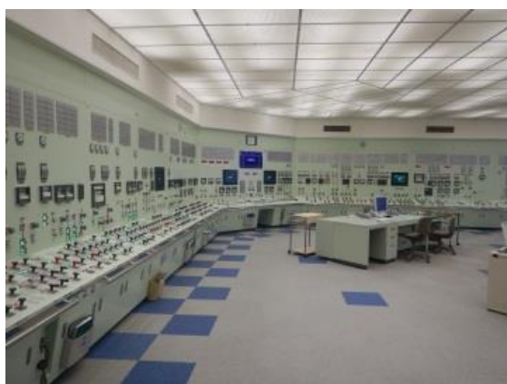
（通常点灯状態）
