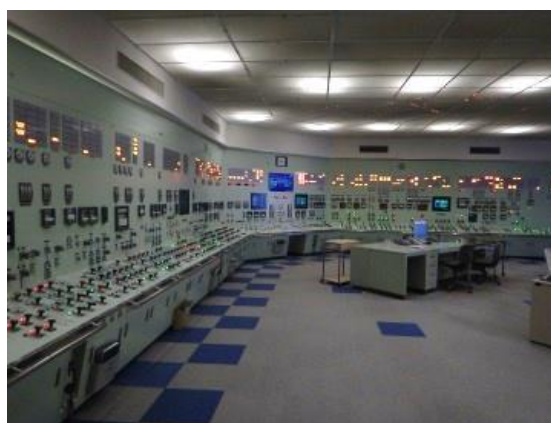
（直流非常灯点灯状態）
