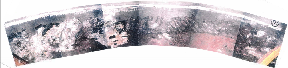
側壁(上半)No.121 写真
