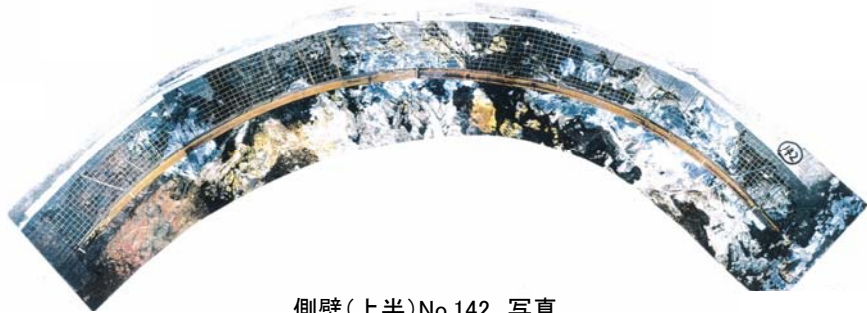
側壁(上半)No.142 写真
