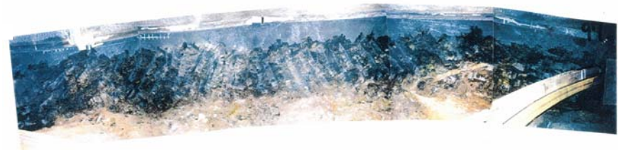
側壁(上半)No.97 写真
