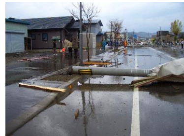
道路側へ倒壊した電柱
