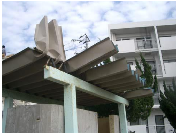
屋外トイレ屋根の損傷
