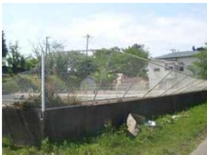
フェンスの変形
