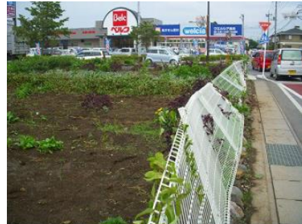
フェンスの変形
