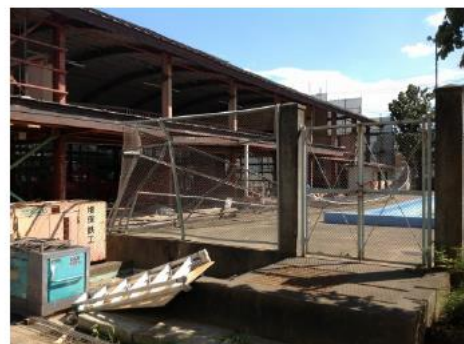
フェンスの変形（工事中の建築物）
