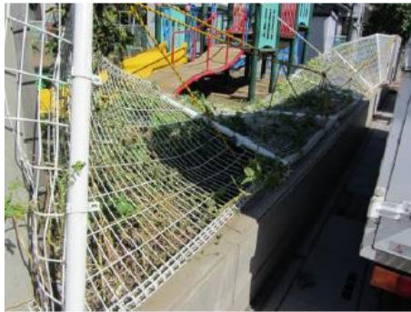
フェンスの変形
