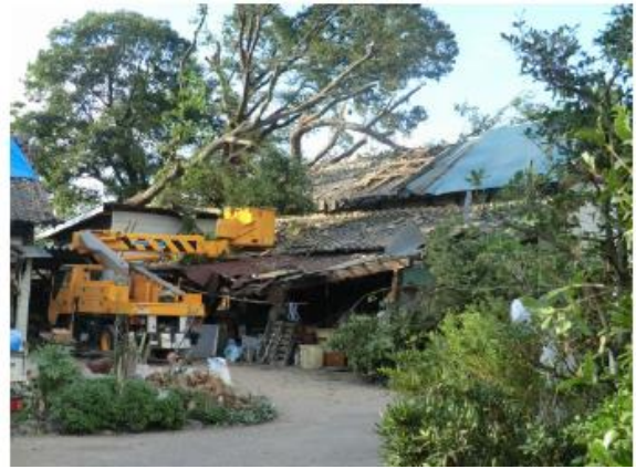
樹木の倒壊による小屋組の被害
