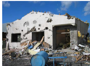
飛来物による被害を受けた建物
