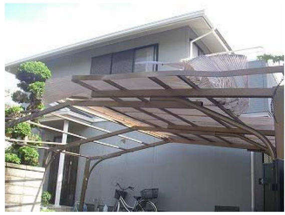
カーポートの被害
