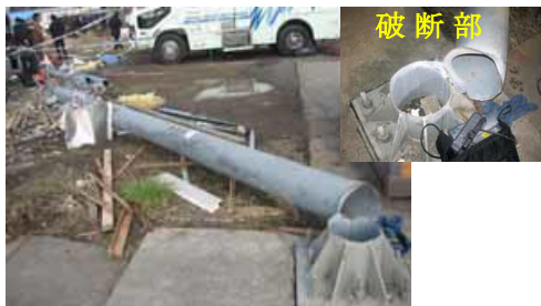
倒壊した道路標識支柱
