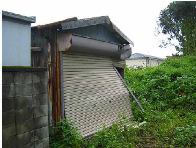
シャッターの外れ
