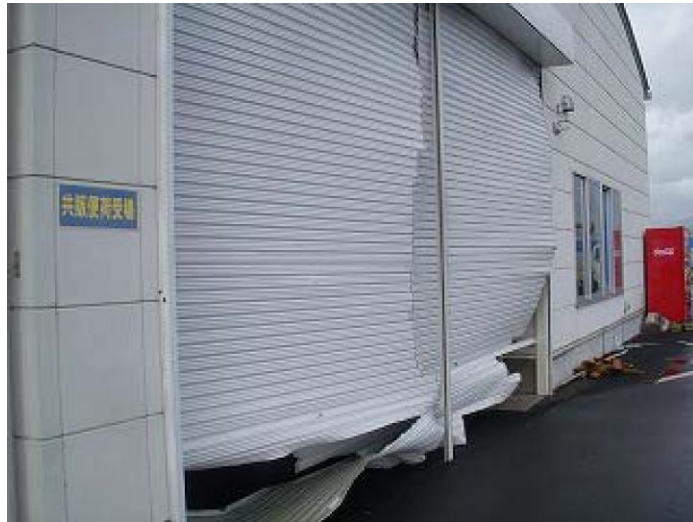
シャッターの変形
