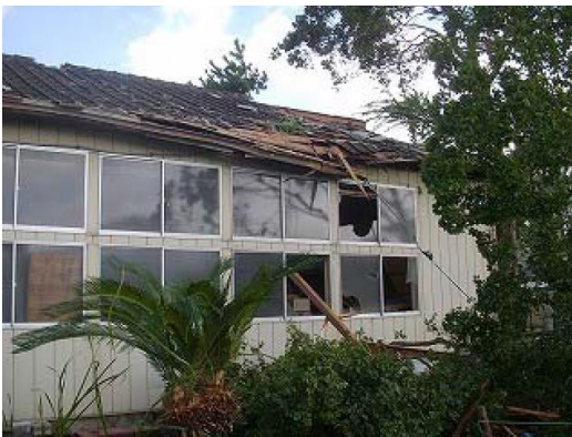
倉庫の窓ガラスと屋根の被害状況
