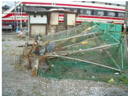
フェンスの著しい変形
