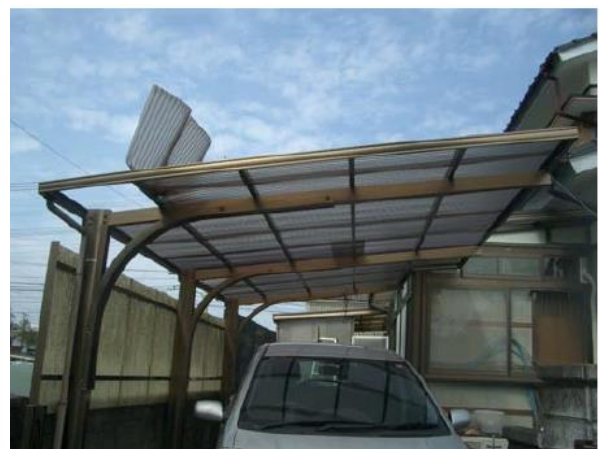
カーポート屋根の損傷
