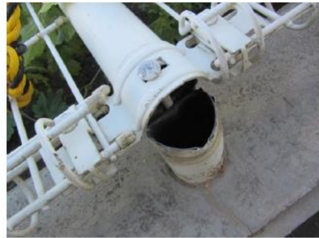
フェンス支柱部の破損
