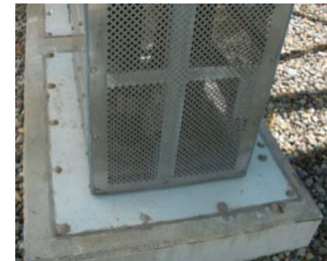
受電開閉設備のパンチング部分 (小動物対策)
