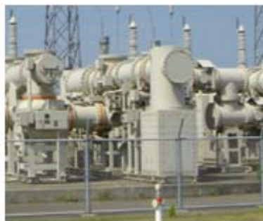
第 3-2-2 図 受変電設備のフェンス (小動物対策)
