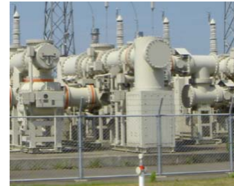
受電開閉設備のフェンス (小動物対策)
