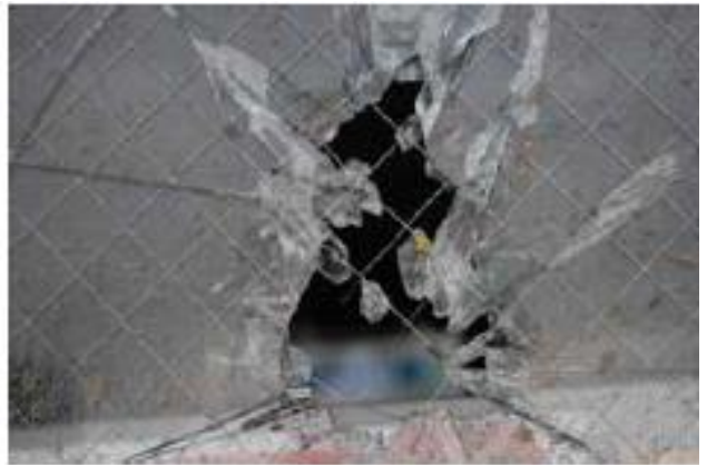
ガラスの被害状況（飛来物衝突痕）
