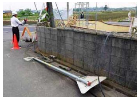
道路標識の倒壊
