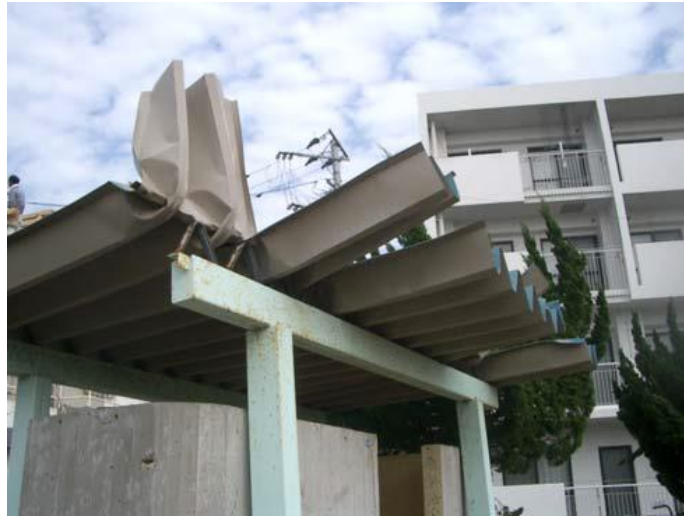
屋外トイレ屋根の損傷
