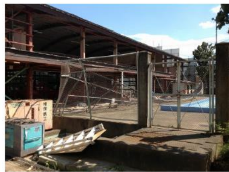
フェンスの変形（工事中の建築物）
