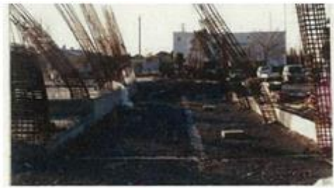
曲がった鉄筋(工事現場)
