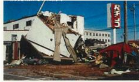
吹き飛ばされた建物
