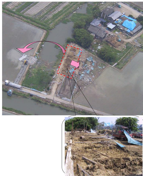
第5-4-1図 平成16年6月27日佐賀県で発生した F2竜巻による屋外屋根の被害状況 (1)
