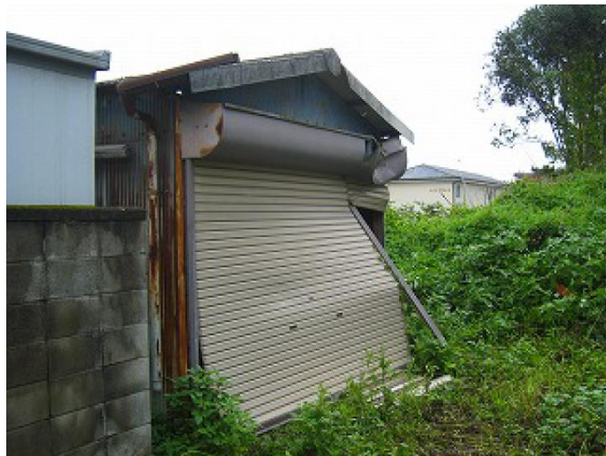
シャッターの外れ
