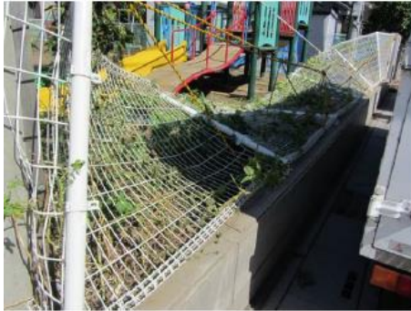
フェンスの変形
