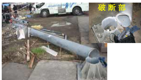
倒壊した道路標識支柱
