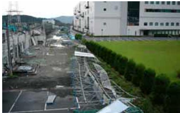
第5-4-29 図 平成18年9月17日宮崎県延岡市で発生した F 2 竜巻による仮設足場の被害状況 (11)
