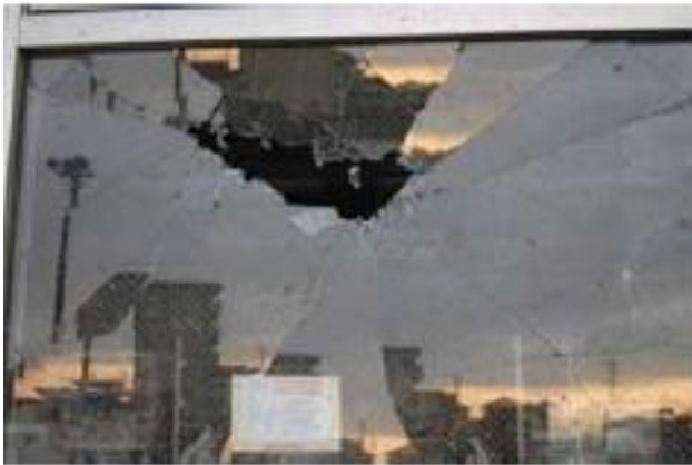
ガラスの被害状況（飛来物衝突痕）
