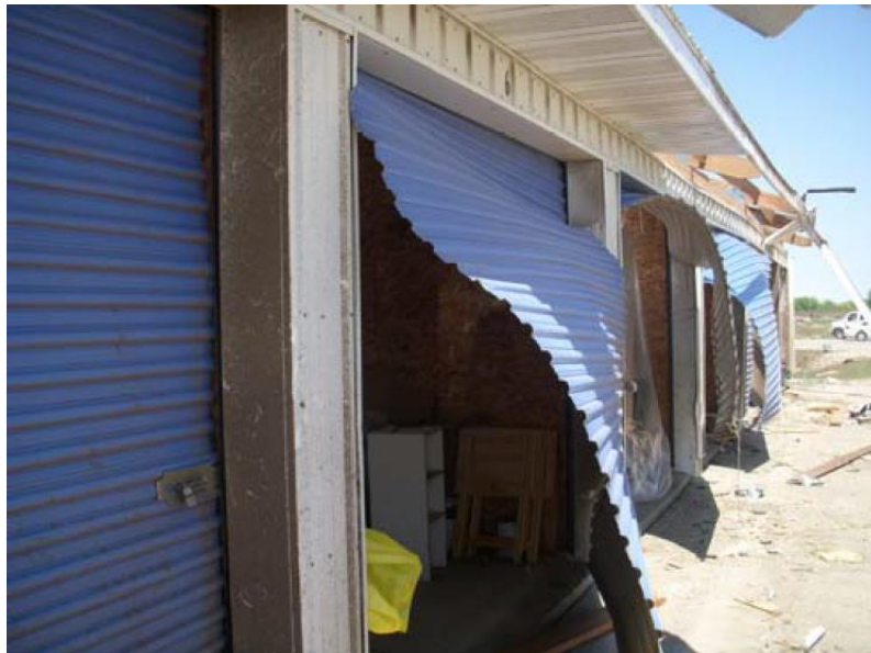
シャッターの外れ
