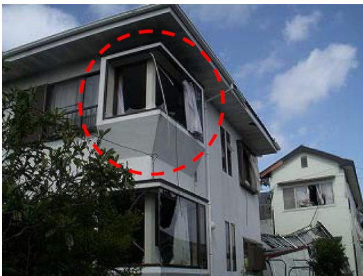
出窓部の窓ガラスの損壊
