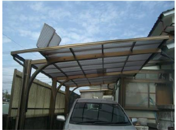
カーポート屋根の損傷
