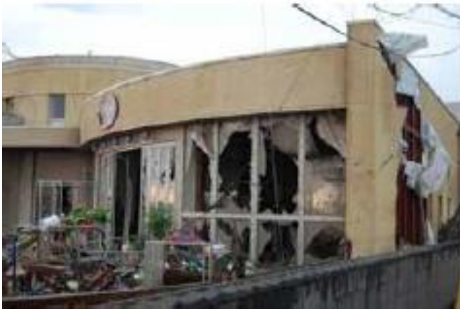
店舗の窓ガラスの被害状況
