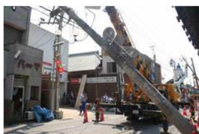
倒れた電柱(復旧作業時)
