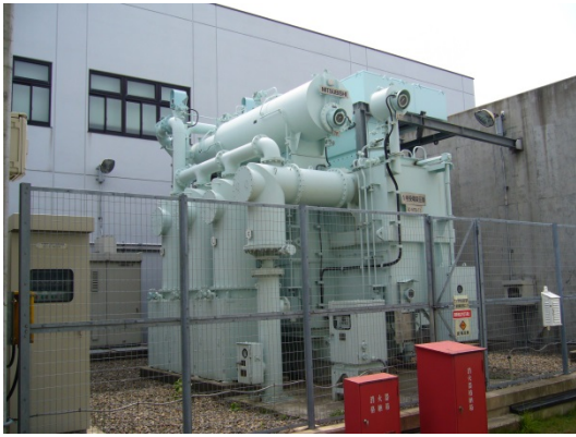
1号受電変圧器
