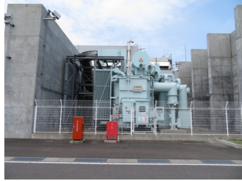
4号受電変圧器
