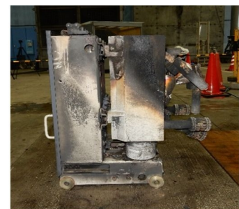
遮断器室アーク発生、アーク火災有、消火後の遮断器の様子
