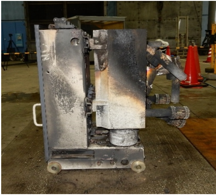
遮断器室アーク発生、アーク火災有、消火後の遮断器の様子
