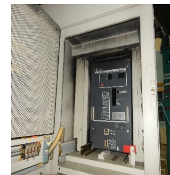
試験後の盤正面の状態
