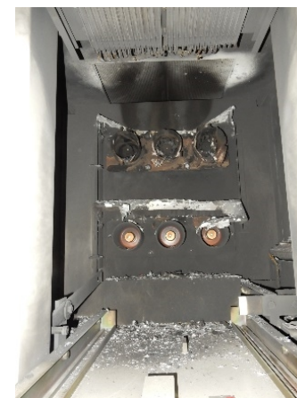
盤内開口部の状態(遮断器室)
