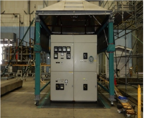
試験状況(M/C(DG)試験時)
