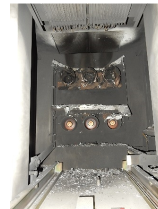
盤内開口部の状態(遮断器室)
