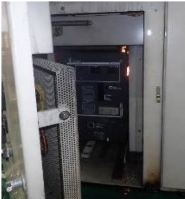
消火前の盤内の様子(盤扉は消火のために手動開)
