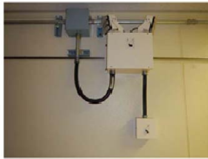
第7図 電源内蔵型照明
