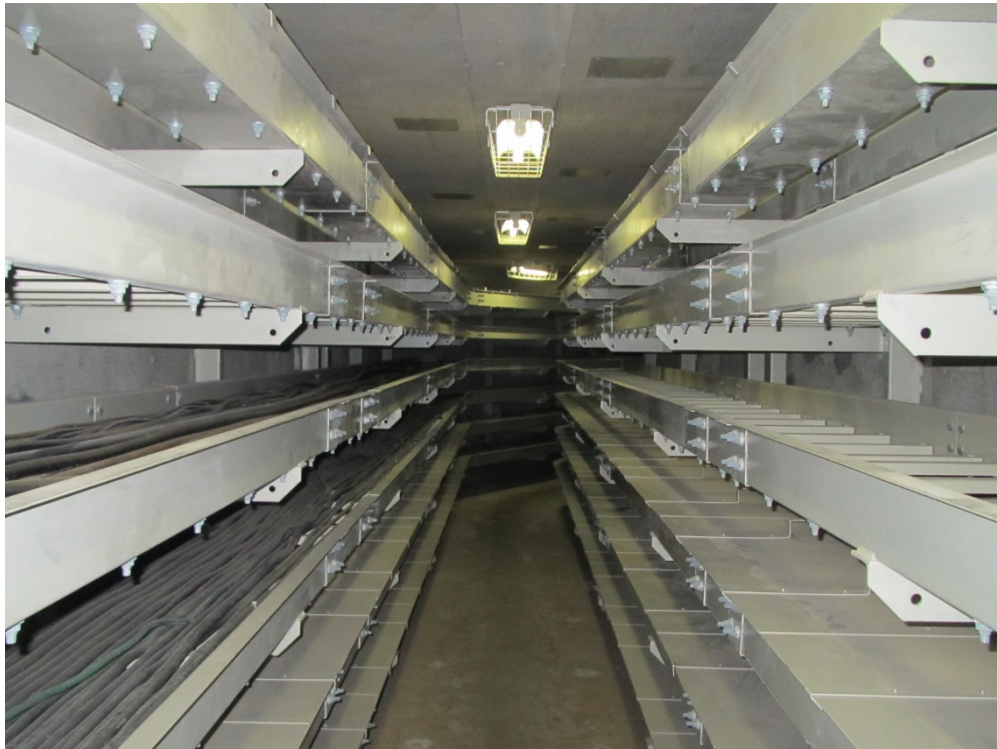
図 2② ケーブルダクト室内
