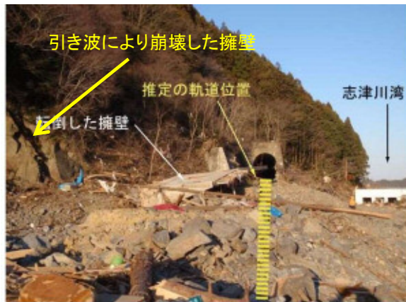
写真1(南三陸町の斜面崩壊状況)
