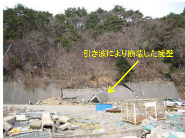
写真2(石巻市雄勝町の斜面崩壊状況)
