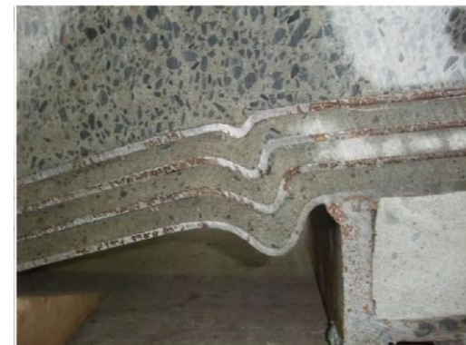
圧縮縁はらみ出し状況
