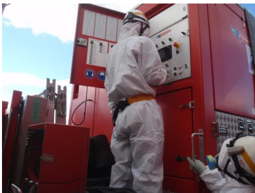
ポンプ起動操作
