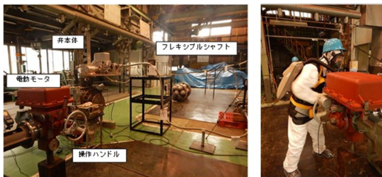
ベント操作（遠隔手動弁操作機構）
