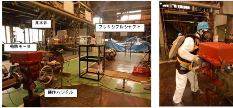
ベント操作（遠隔手動弁操作機構）
