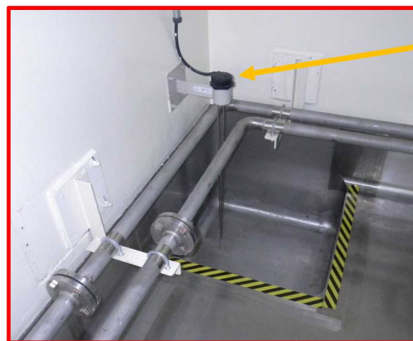
漏えい検知器 (電極式)
